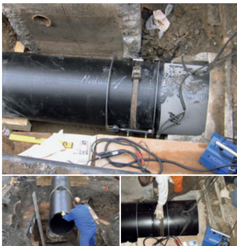
Sanierung einer defekten Stahlbetonrohrleitung mit SIMONA® PE 100 Rohrmodulen SIMOFUSE® mit integrierten Heizwendeln. Oben: die Verschweißung der Rohrmodule mittels Heizwendelschweißung. Unten: Das Einbringen der Rohrmodule in die Baugrube und das Altrohr.
